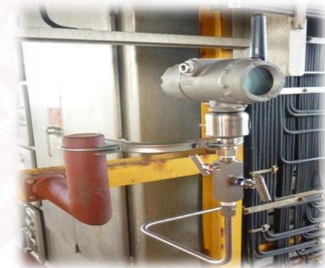
Monitoreo de la presión del suministro Hidraulico Consola Baker, Chuc B, Abkatun Pol Chuc
