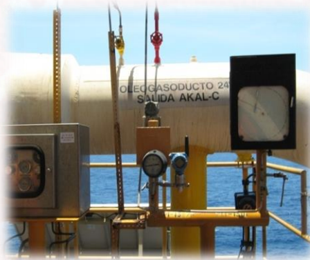
Monitoreo de Presión Oleogaseoducto hacia Akal – C., Akal-BN, Cantarell
