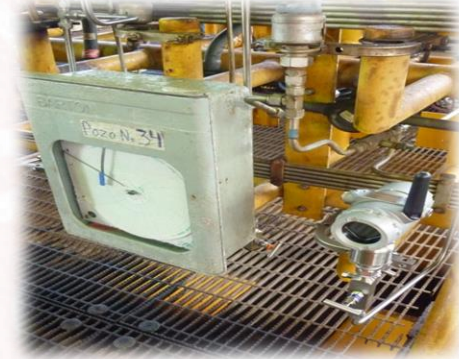
Automatización de toma de lecturas de presión en distintos puntos de la Instalacion.
